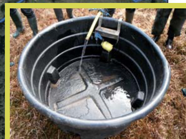
Le flotteur bloque l'arrivée d'eau une fois le bac plein. Le prélèvement d'eau au ruisseau est ainsi limité au maximum.
