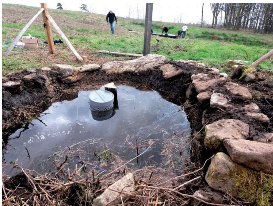
Un abreuvoir (au second plan) installé avec un Filtre décanteur ® placé dans une pêcheirie – S.Massy ; Syndicat le Lac de Vassivière-
