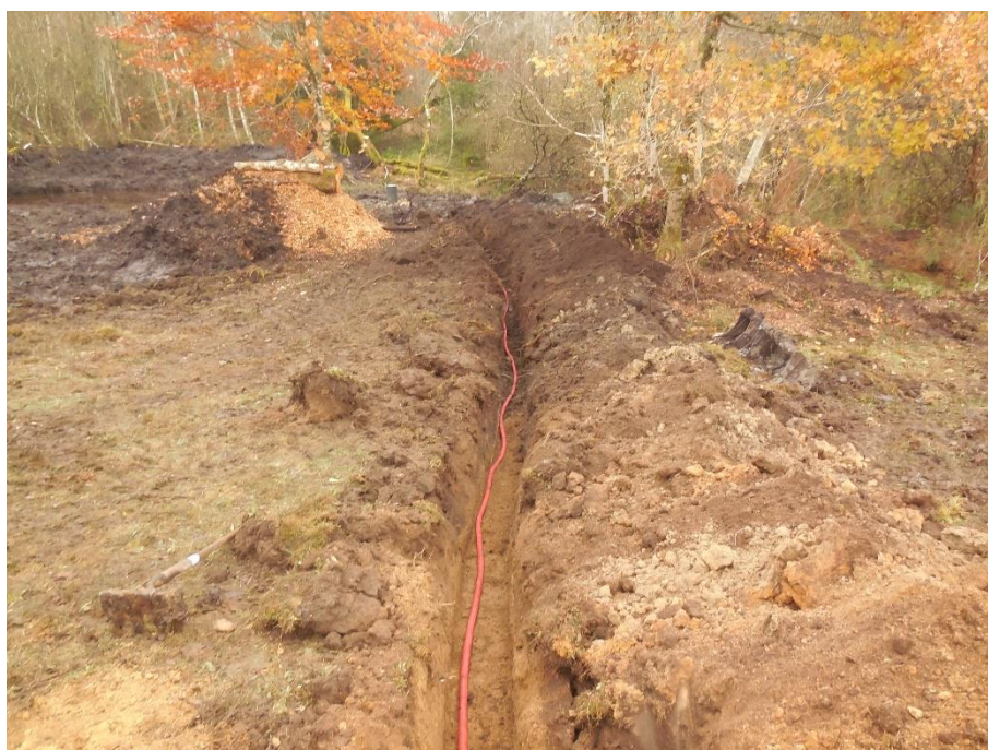
Photographie 4: Tuyau d'eau entre la prise d'eau et le système de pompage
