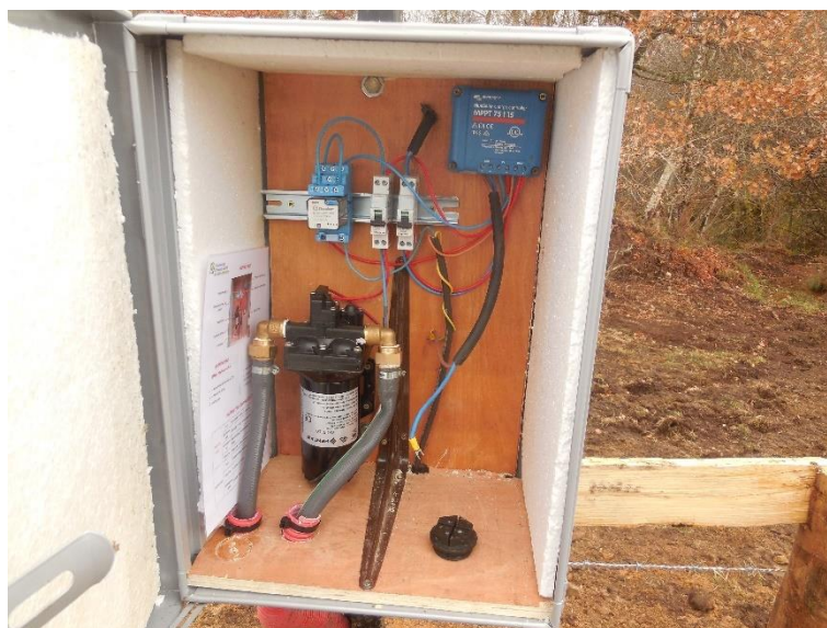
Photographie 13: Système solaire en mode hiver (disjoncteur en position OFF)
